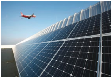
Photovoltaikanlage auf dem Dach von Halle 7
