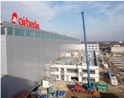
Die neue Halle 7. Nach Fertigstellung bietet sie Platz für drei Großraumflugzeuge gleichzeitig
